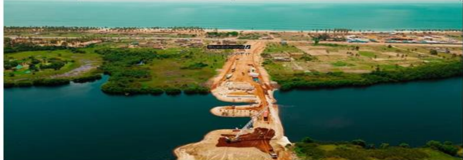
Travaux de construction du pont entre la Route de Pêche et la RNIE 1/
